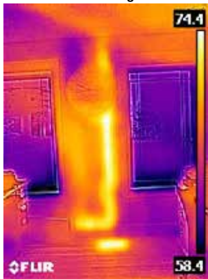
Tubo de drenaje caliente en la pared
